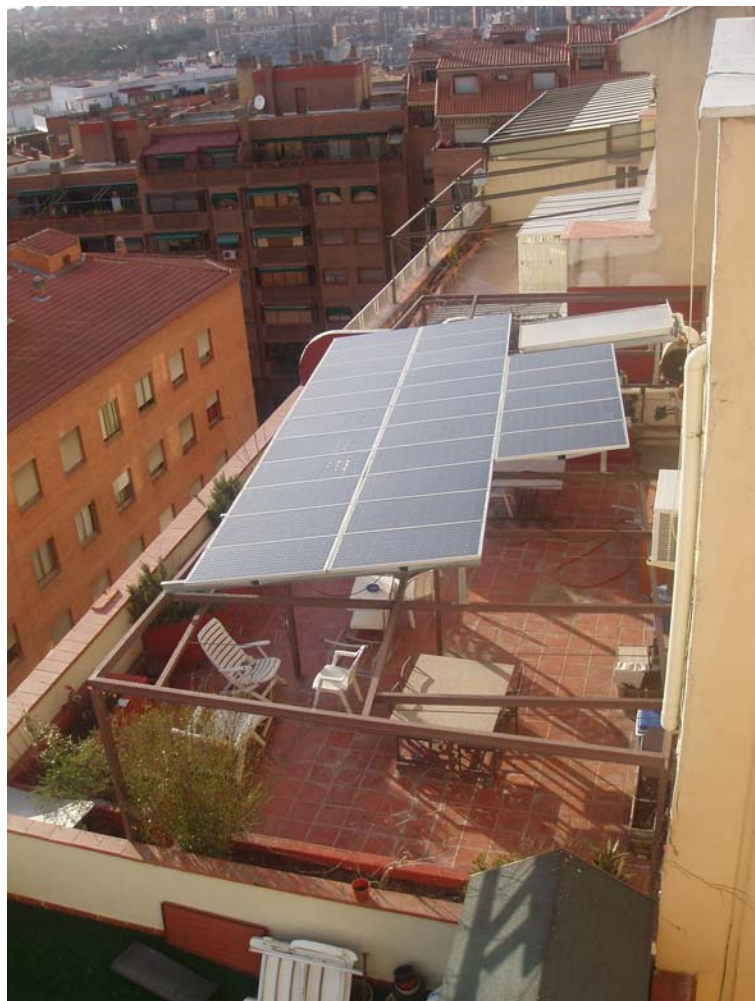
Fig. 1. Vista del generador fotovoltaico desde una terraza vecina.
